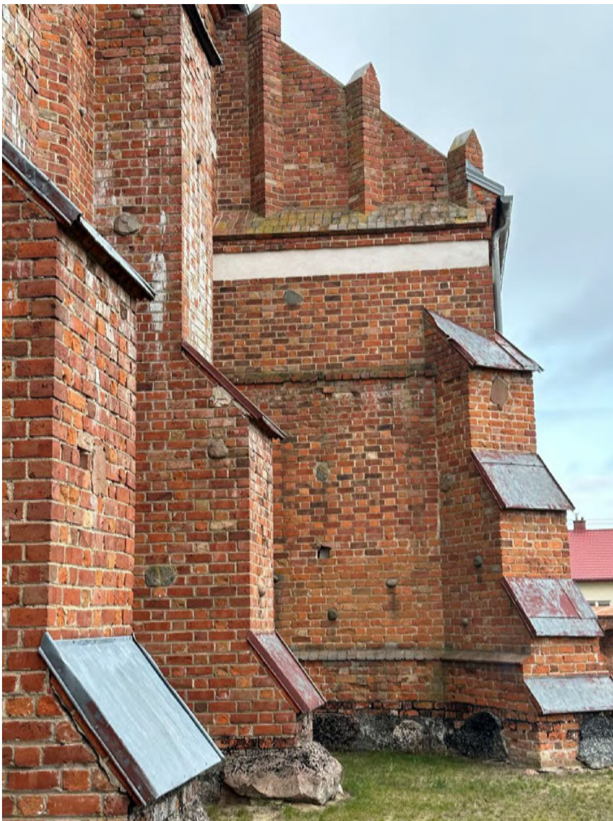
Fot. 21. Po lewej widoczne przypory elewacji południowej korpusu nawowego, w głębi na wprost elewacja zachodnia kaplicy. Dobrze widoczne są nawarstwienia bitumiczne w obrębie kamiennego cokołu i zły stan zachowania elementów blacharskich.
