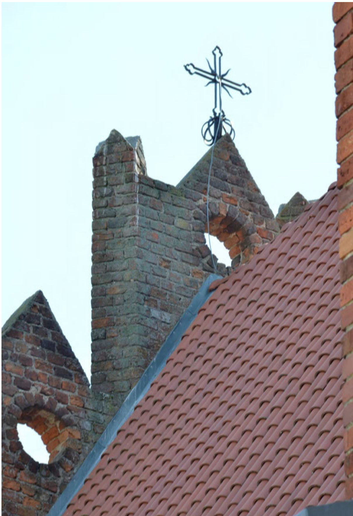
Fot. 32. Szczyt prezbiterium – widok od strony tylnej. Widoczne intensywne nawarstwienia biologiczne.
