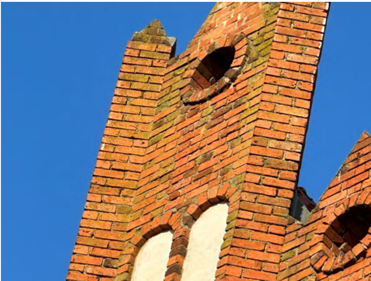
Fot. 10. Detal zwieńczenia sterczyny – intensywny porost glonów i erozja powietrzna spoin.
