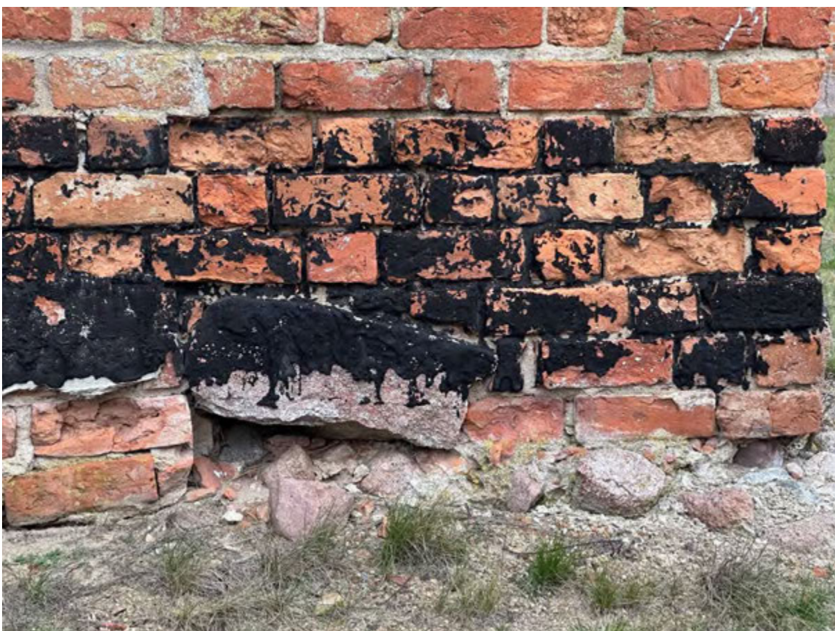
Fot. 26. Nawarstwienia bitumiczne na cokole kaplicy, erozja cegły.
