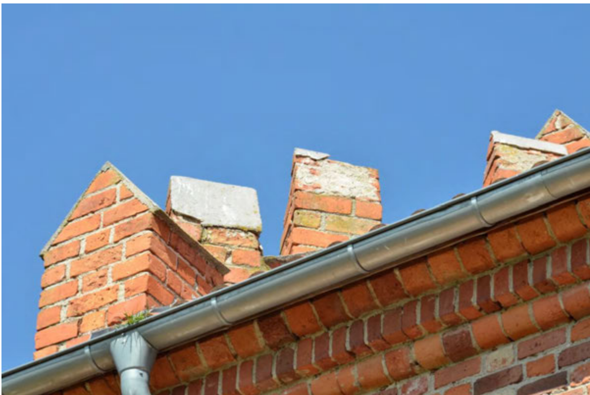
Fot. 11. Sterczyny elewacji frontowej w ujęciu od tyłu – erozja powłoki tynkarskiej na sterczynach.
