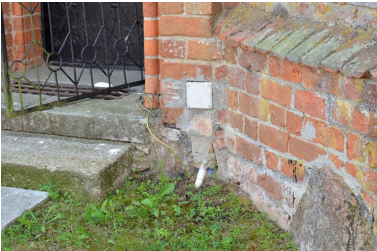
Fot. 44. Fragment muru w pobliżu wejścia do zakrystii – wtórne instalacje i widoczne okablowanie.
