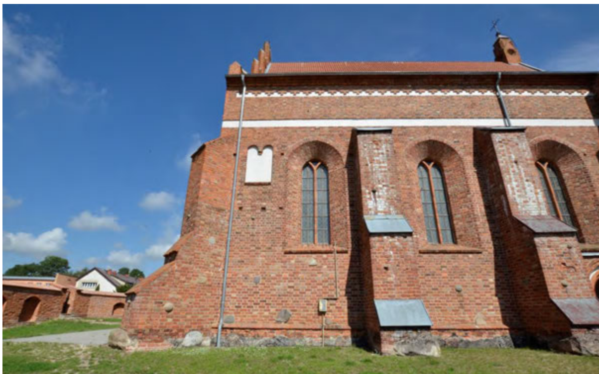
Fot. 14. Stan zachowania elewacji południowej – część zachodnia.
