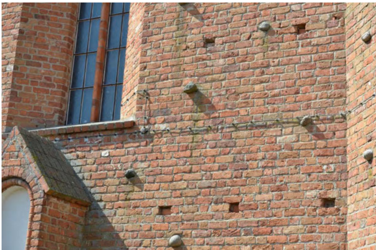
Fot. 30. Fragment elewacji prezbiterium – stan zachowania. Widoczne smugi nawarstwień biologicznych bezpośrednio pod elementami wysuniętymi przed lico ściany.
