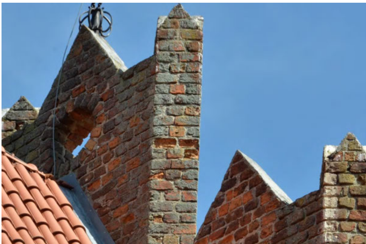
Fot. 34. Szczyt prezbiterium – widok od tyłu. Zły stan zachowania cegieł.
