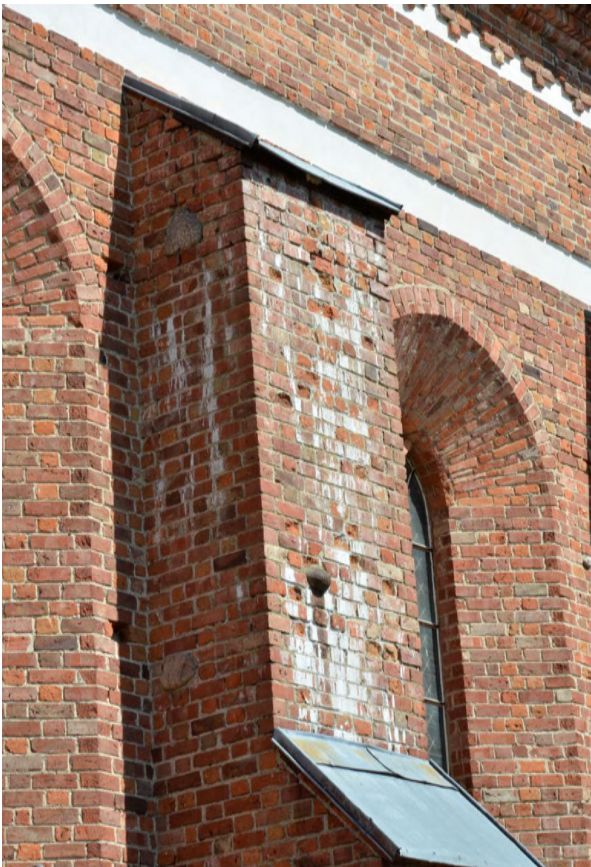
Fot. 16. Stan zachowania lica przypory w elewacji południowej – nawarstwienia węglanu wapnia i erozja powierzchni cegły. Zdeformowane obróbki blacharskie.
