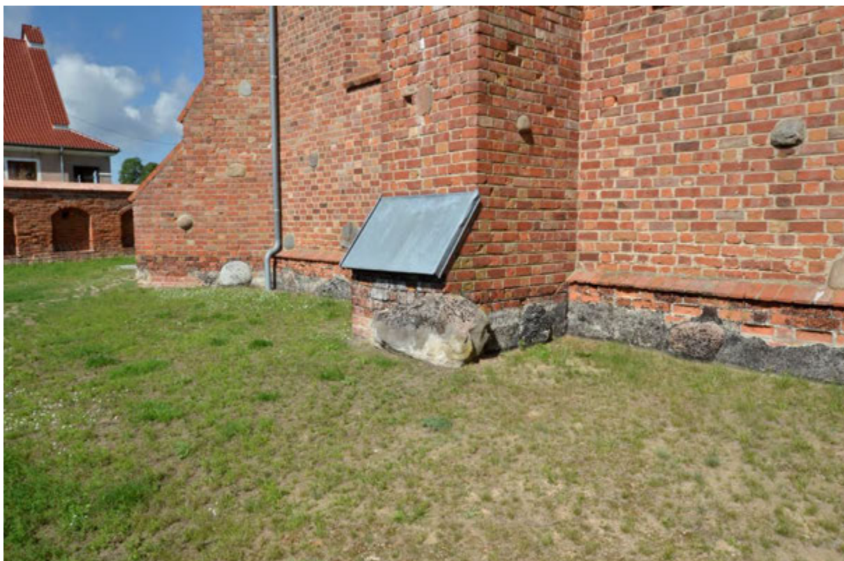
Fot. 17. Dolna partia elewacji południowej – widoczne pasmo głazów zastosowanych do budowy fundamentów kościoła oraz erozja cegły.
