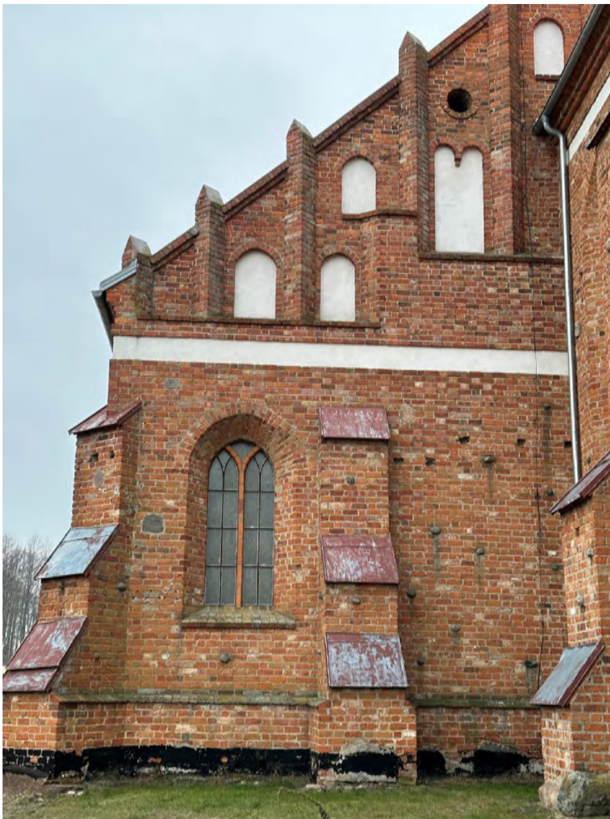
Fot. 22. Elewacja wschodnia kaplicy – poza nawarstwieniami na cokole widoczne liczne uszkodzenia cegieł – otwory po instalacjach(?). Obróbka blacharska rynny wymaga korekty.
