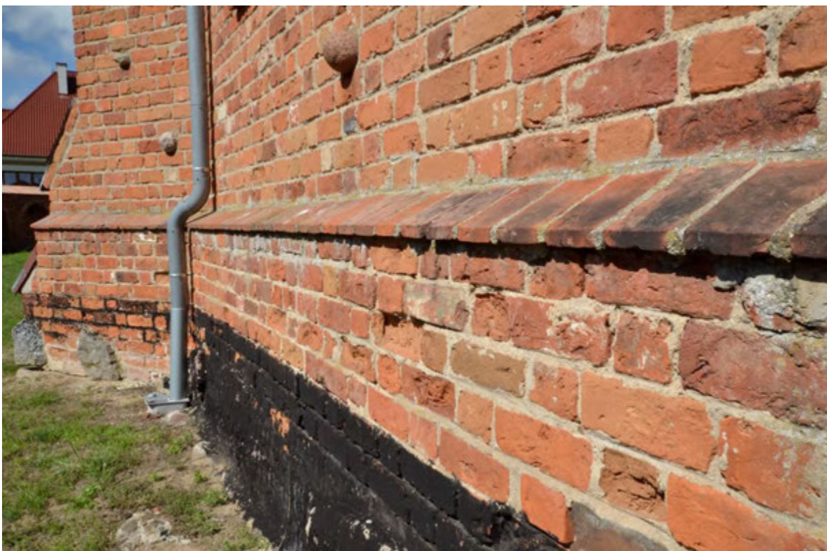
Fot. 25. Fragment cokołu w południowej elewacji kaplicy – miejscowa erozja cegieł.
