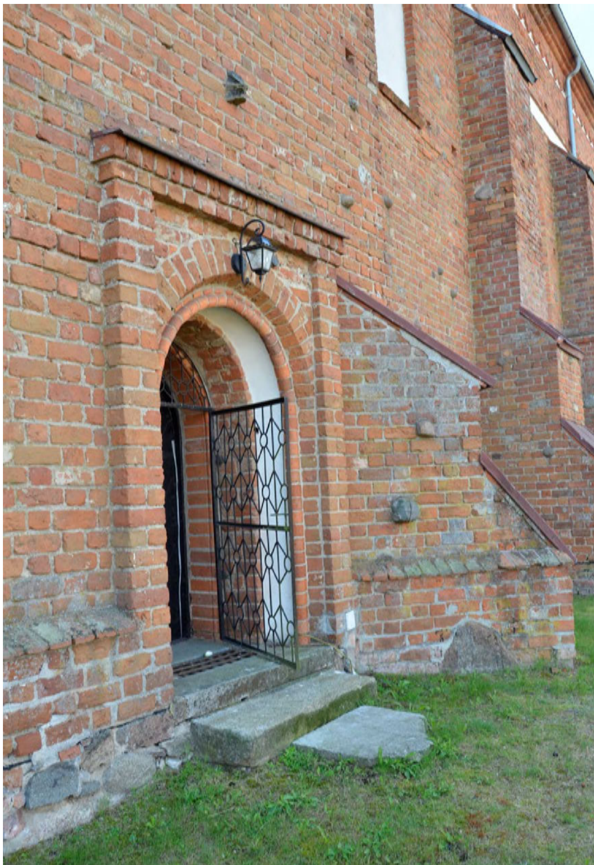
Fot. 43. Wejście do zakrystii. Na przyporze widoczne reperacje wykonane zaprawą cementową.
