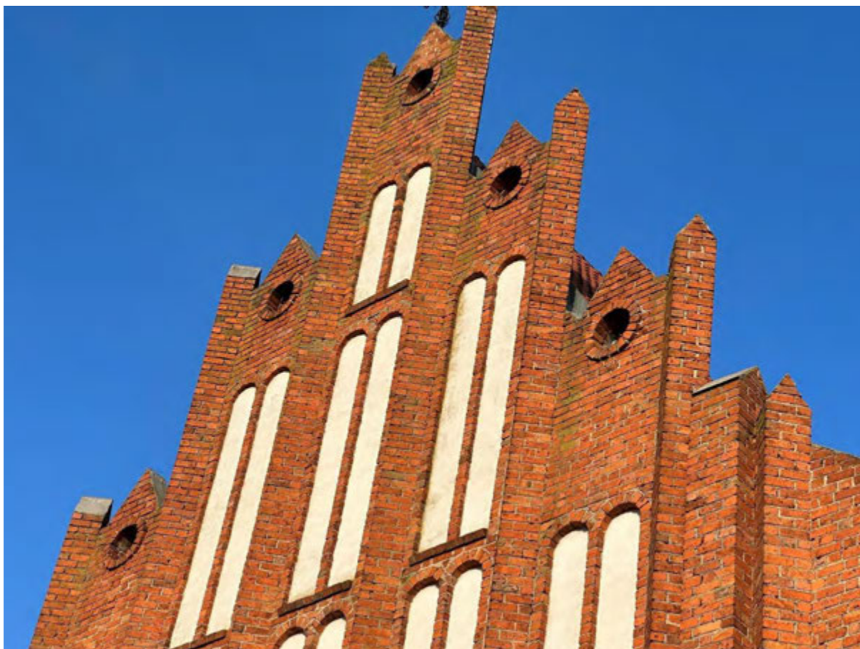
Fot. 8. Fragment szczytu w elewacji frontowej – stan zachowania. Czytelne strefy porostu glonów.
