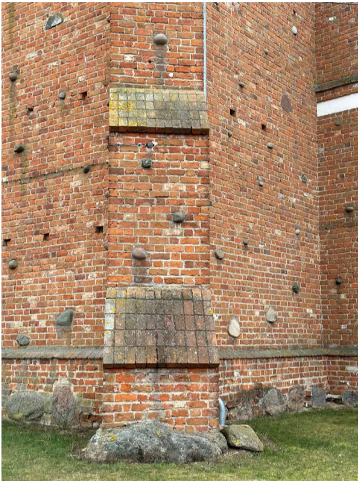
Fot. 36. Przypora narożna prezbiterium od strony północnej. Widoczne charakterystyczne dla tego obiektu liczne inkluzje kamienne w ceramicznym wątku. Na nakrywach przypory silne nawarstwienia biologiczne.
