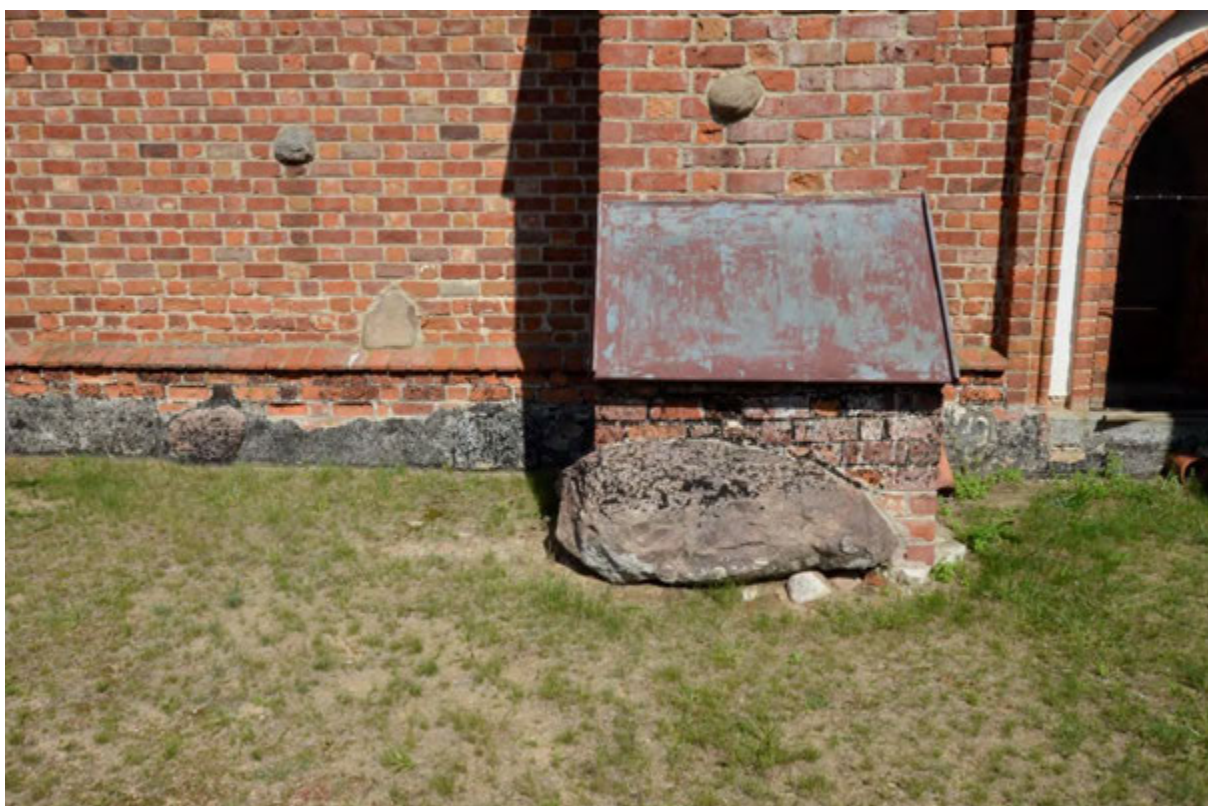
Fot. 18. Dolna część elewacji południowej w części nawowej – ciemne nawarstwienia na powierzchni kamienia i cegły to pozostałości warstwy bitumicznej pełniącej pierwotnie rolę izolacji.
