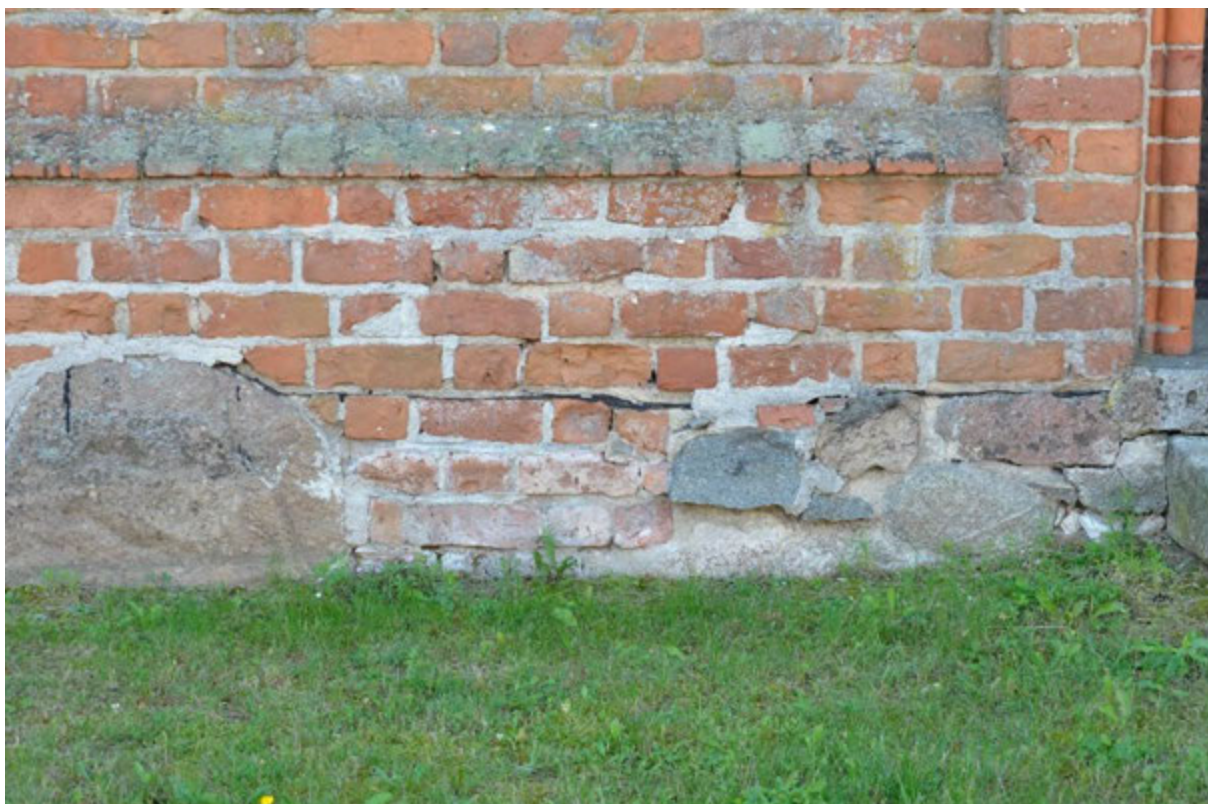
Fot. 42. Fragment cokołu zakrystii – widoczne pasmo izolacji przeciwwilgociowej.
