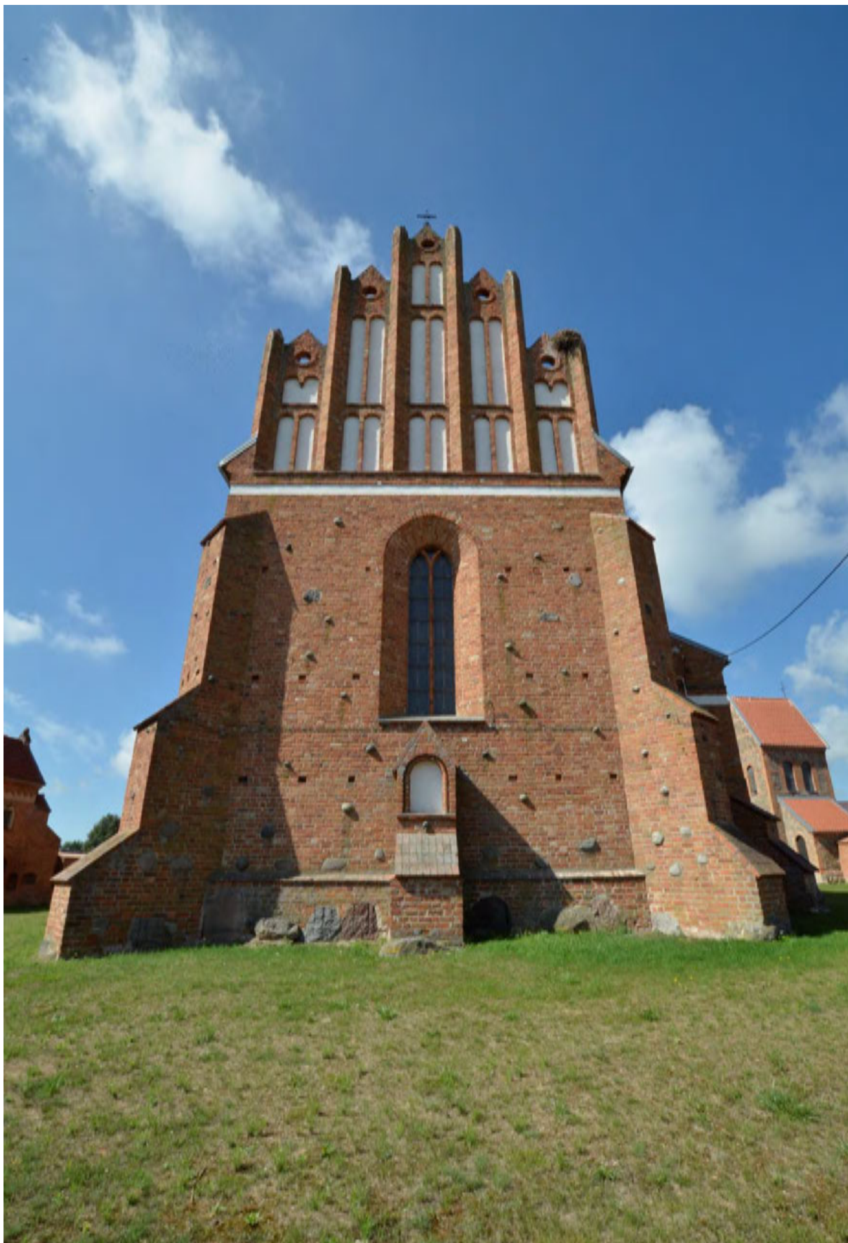
Fot. 29. Elewacja prezbiterium – stan zachowania.
