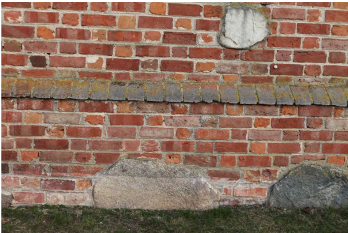
Fot. 7. Fragment elewacji frontowej na lewo od wejścia – stan zachowania wątku ceramicznego.
