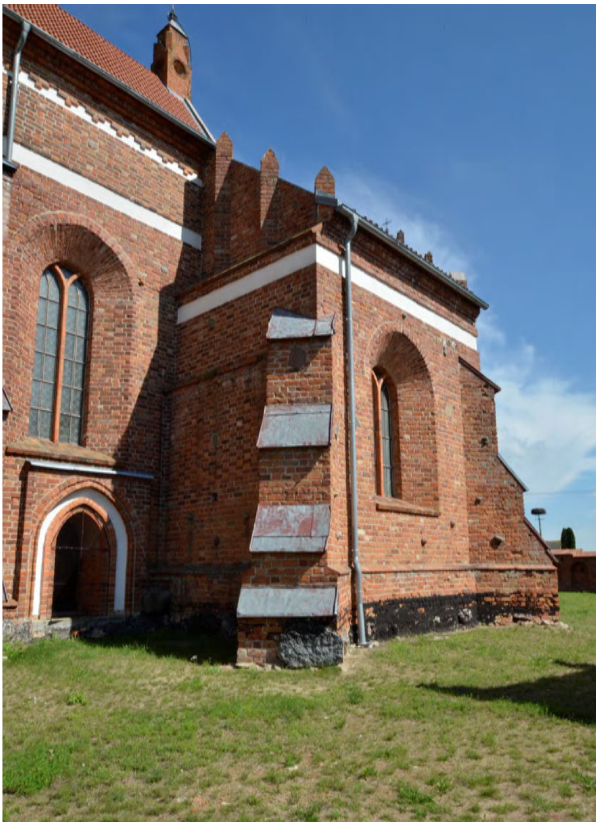
Fot. 19. Kaplica dobudowana do korpusu nawowego od strony południowej – widok w kierunku północno-wschodnim. Widoczny czarny pas powłoki bitumicznej.
