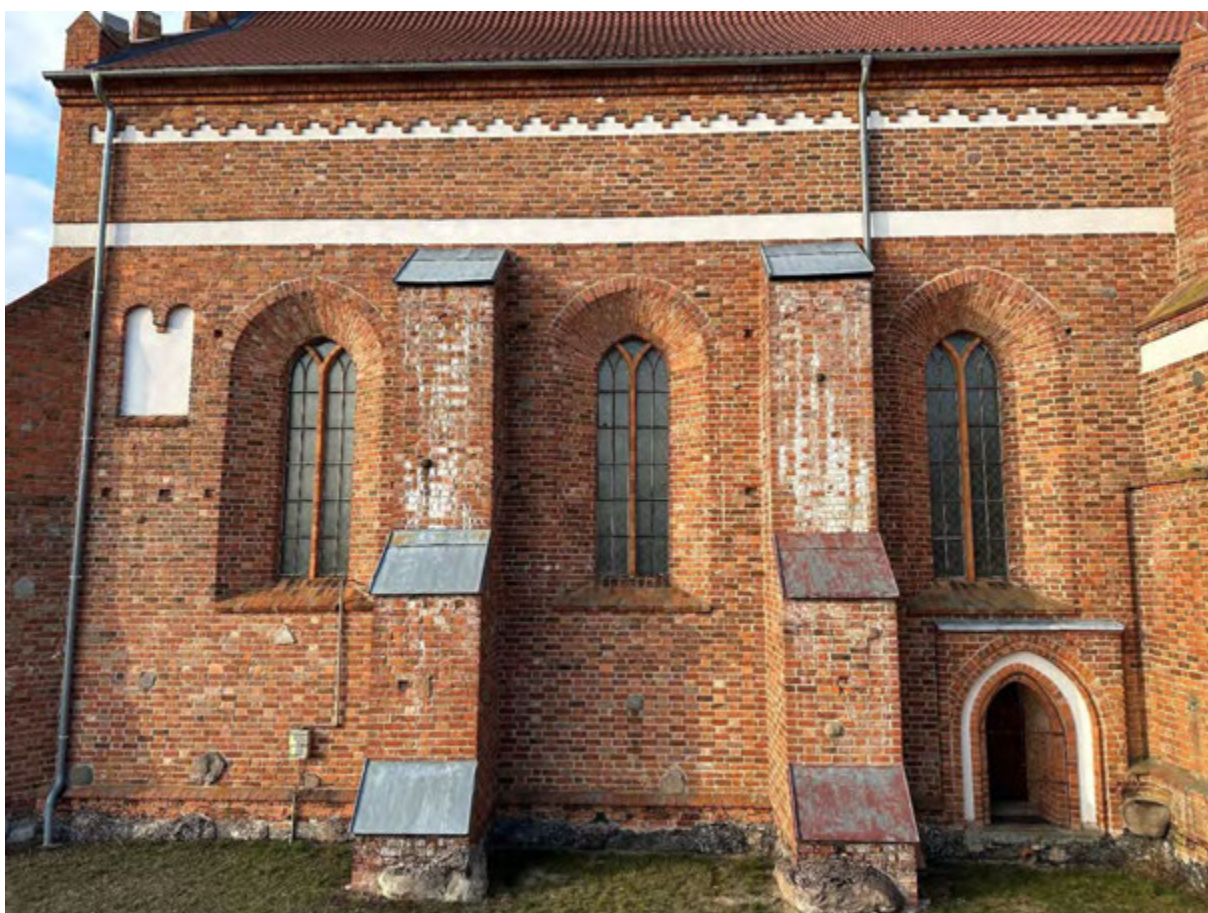
Fot. 15. Fragment elewacji południowej – część nawowa. Widoczne obfite nawarstwienia węgla wapnia na licach przypór oraz ich blaszane pokrywy.
