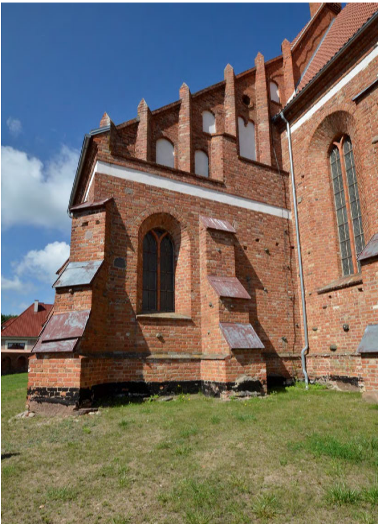
Fot. 20. Kaplica – widok w kierunku północno-zachodnim. Widoczny czarny pas powłoki bitumicznej.
