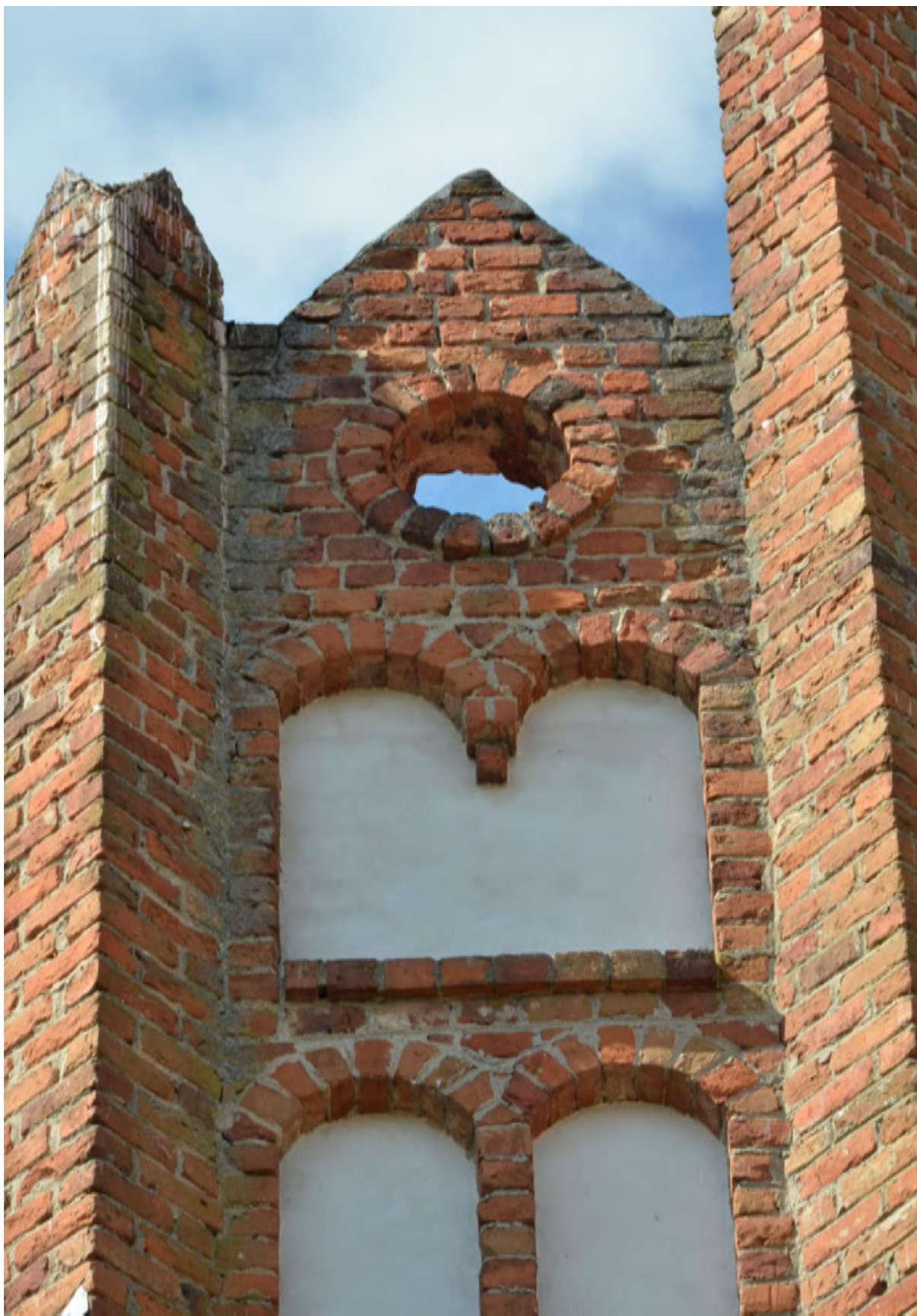
Fot. 35. Fragment szczytu prezbiterium – stan zachowania zwieńczenia jednej z osi – widoczne nawarstwienia biologiczne, erozja cegły i spoinowania w partiach narażonych na wiatr.
