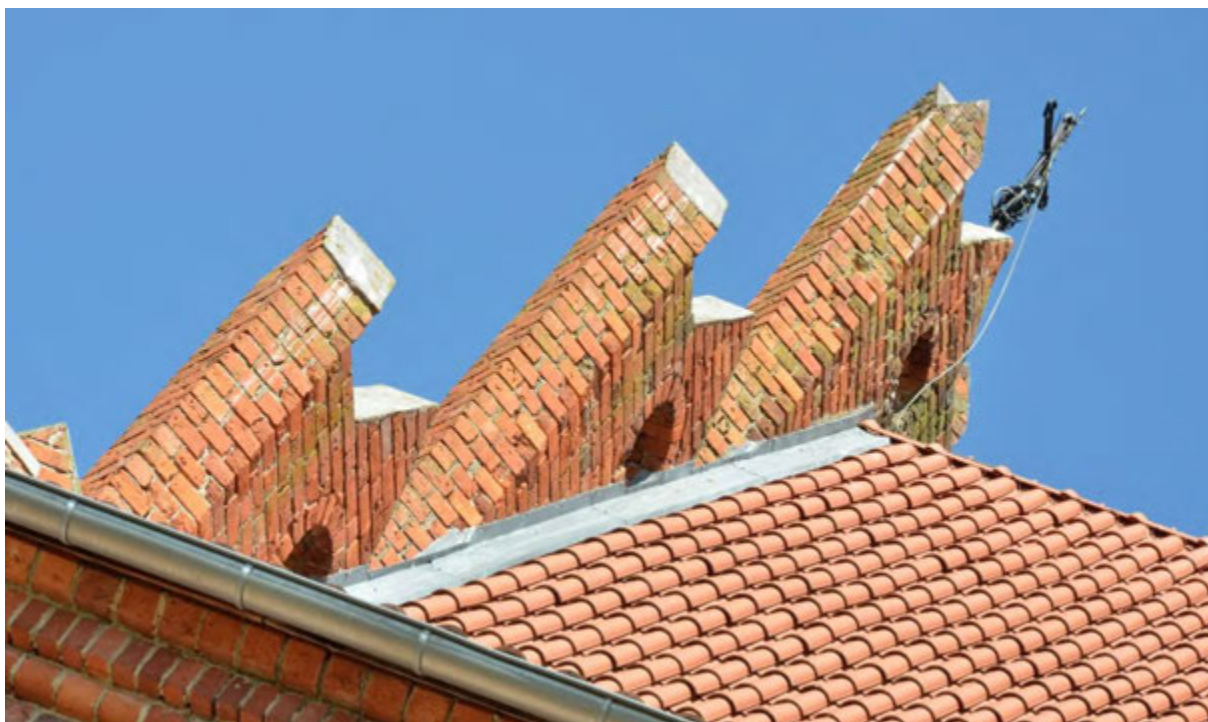
Fot. 12. Sterczyzny w elewacji frontowej (od tyłu) – widoczne nawarstwienia biologiczne, obróbka blacharska dachu i zwisający bez mocowanie przewód odgromienia.
