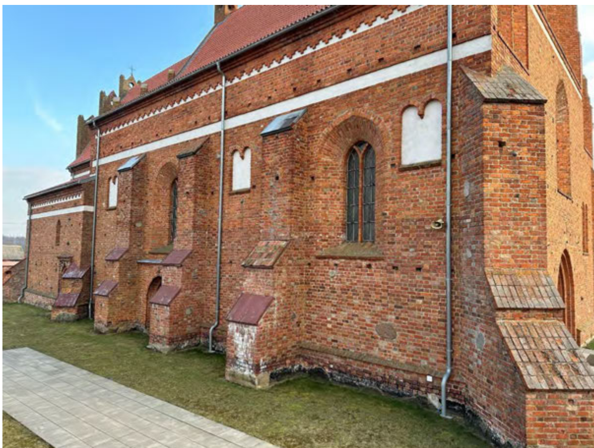
Fot. 50. Elewacja północna – widoczne obfite nawarstwienia węglanu wapnia na przyporach i pozostałości powłoki bitumicznej na cokole.
